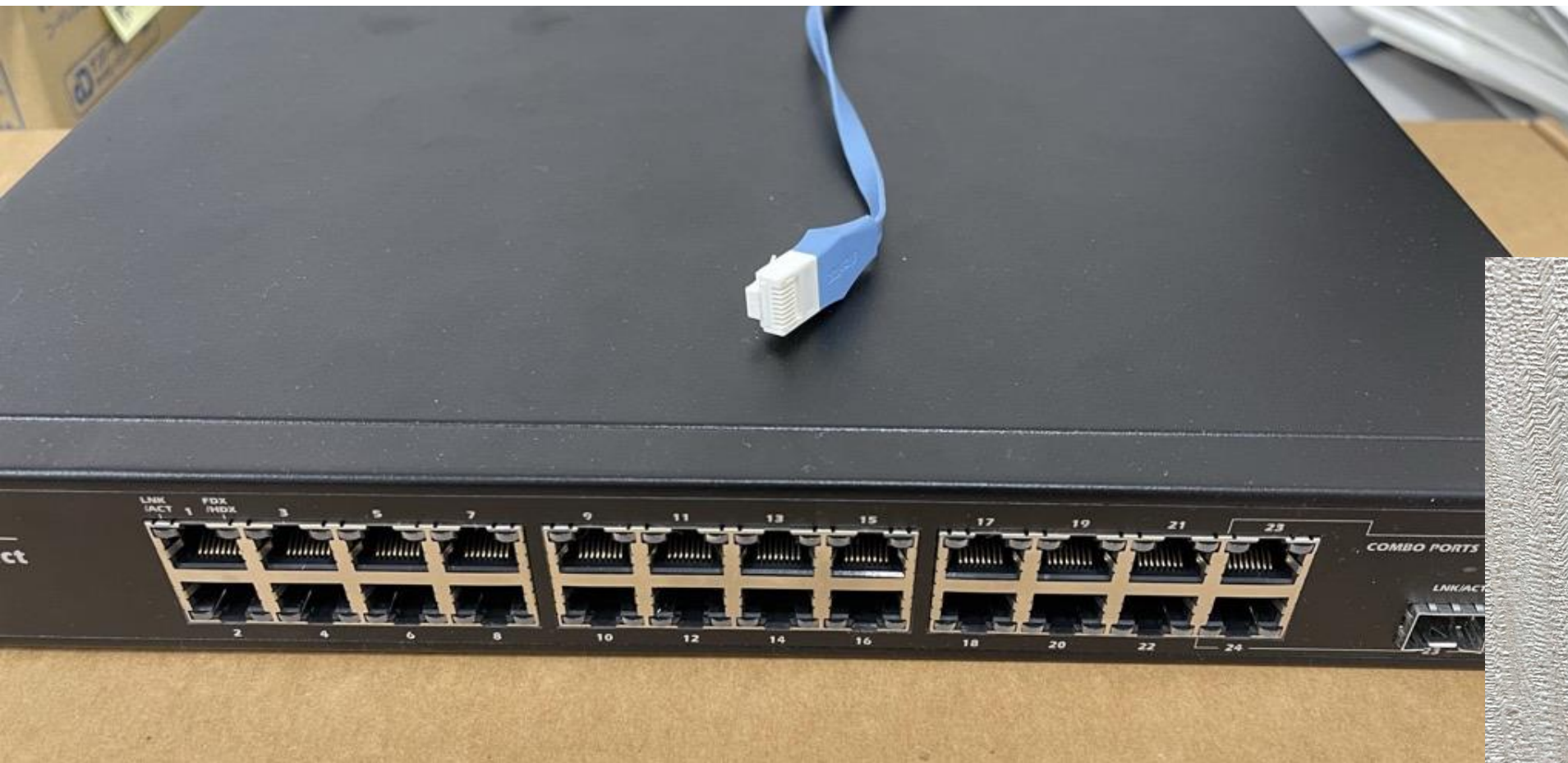
Ethernetスイッチとケーブル
