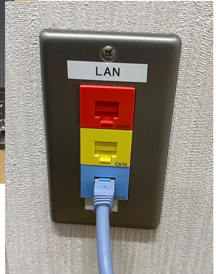
壁に設置されているLANポート
